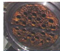
開放型冷却塔使用時の 水冷凝縮器内部
